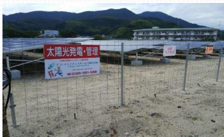
広島県竹原市 PCS: デルタ 400kWシステム
