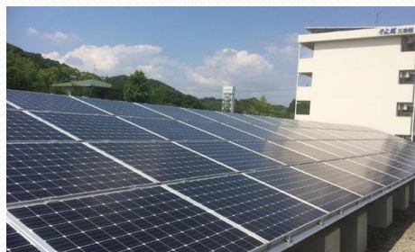
佐賀県鳥栖市 PCS:新電元 50kWシステム
