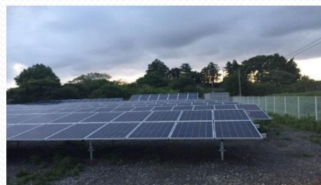
群馬県伊勢崎市 PCS:SMA 57.24kWシステム
