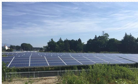
千葉県印西市 PCS: 田淵 1MWシステム
