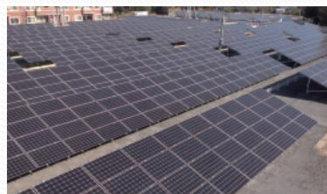
宮崎県都城市 PCS:田淵 396kWシステム
