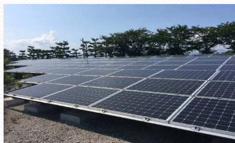
熊本県八代市 PCS: ジーエスユアサ 40kWシステム
